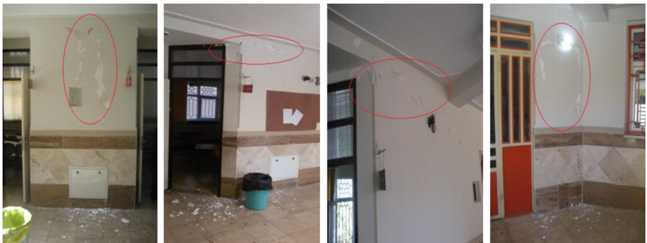
شکل (۱۱): ترک‌های سطحی در دیوارهای مدرسه پس از زلزله ۲۱ آبان ۱۳۹۶ استان کرمانشاه (Kahrizi et al., 2020).
