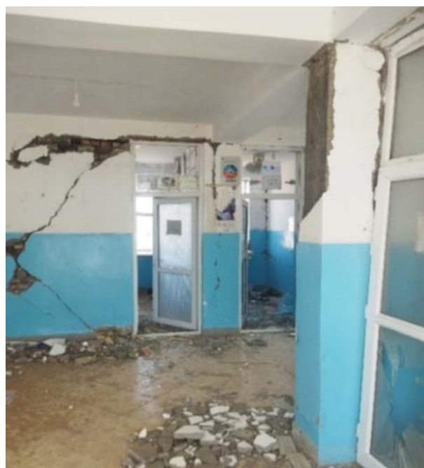
شکل (۳۶): آسیب‌های وارده بر دیوارهای درون‌قابی سازه زلزله‌زده.
