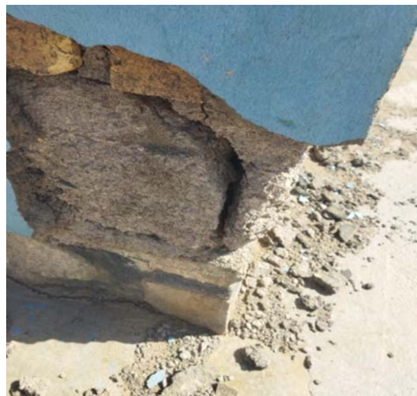
شکل (۱۴): نمونه از کیفیت بتن یک مدرسه در روستای سیا آب.
