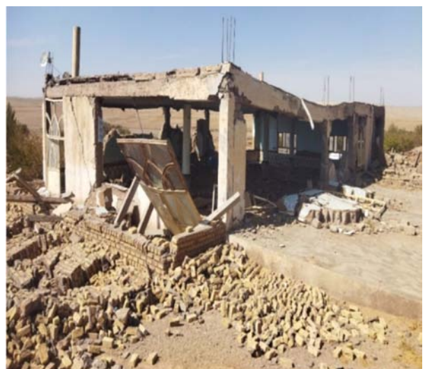
شکل (۱۱): آسیب شدید ساختمان بتنی در روستای کشکک.
