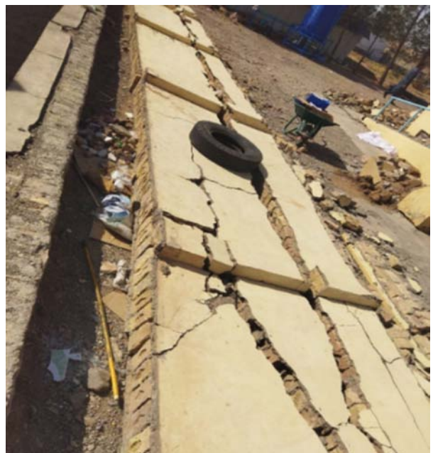
شکل (۲۸): عدم کلاف‌بندی دیوار با شناژ افقی.
