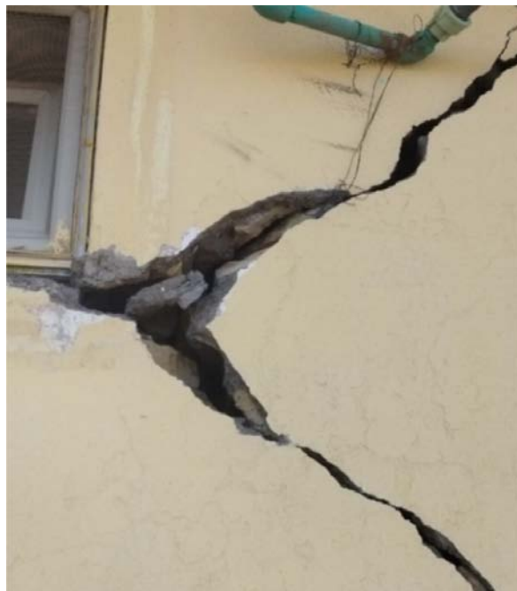
شکل (۳۴): شکست از قسمت بازشو.
