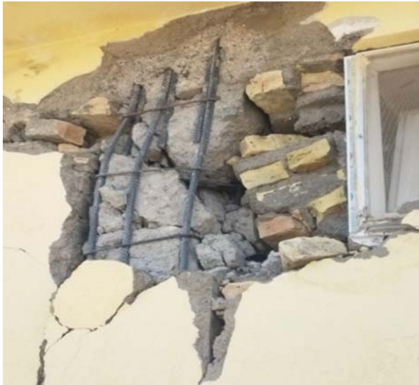
شکل (۱۲): آسیب شدید ستون ساختمان بتنی در روستای وردک‌ها.
