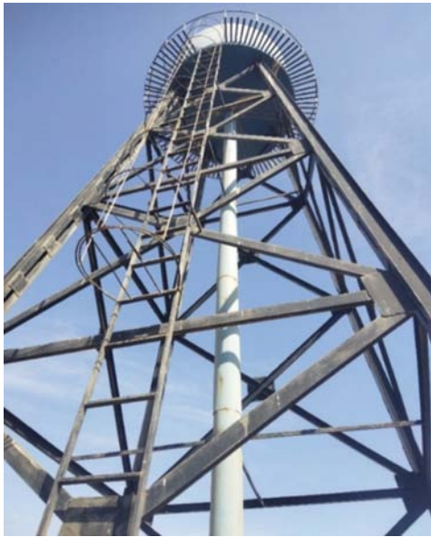
شکل (۸): موجودیت بادبندهای ضربداری در سازه فلزی.
