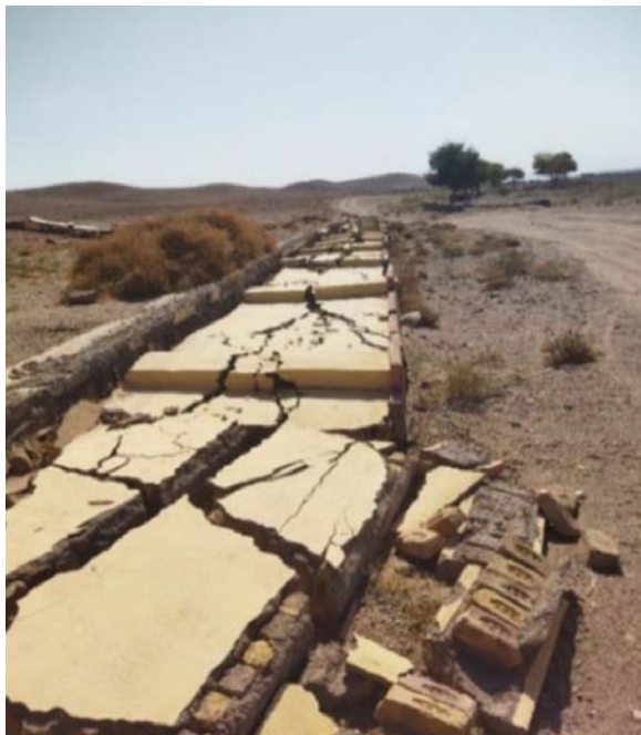
شکل (۲۶): تخریب دیوار محوطه به خاطر عدم کلاف‌بندی درست در امتداد دیوار.
