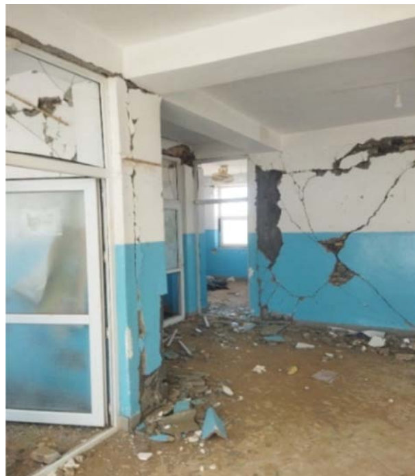
شکل (۳۵): آسیب‌های وارده بر دیوارهای درون‌قابی سازه زلزله‌زده.
