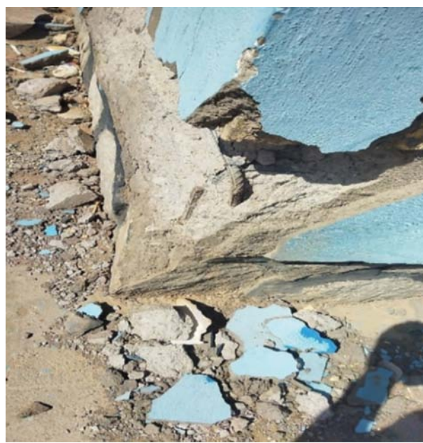
شکل (۱۵): نمونه از کیفیت بتن یک مدرسه در روستای سیا آب.
