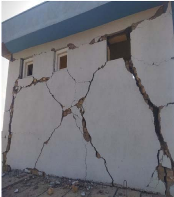
شکل (۳۳): شکست از قسمت بازشو.
