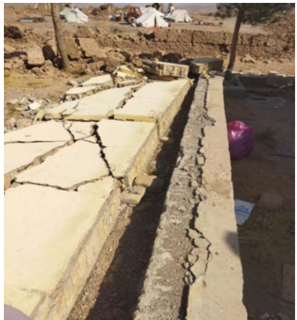
شکل (۲۷): عدم کلاف‌بندی دیوار با شناژ افقی.
