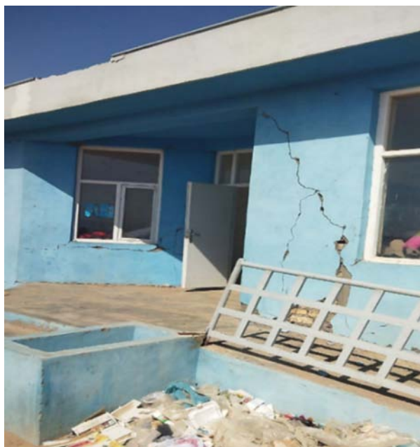
شکل (۳۰): آسیب دیوار از قسمت بازشو.
