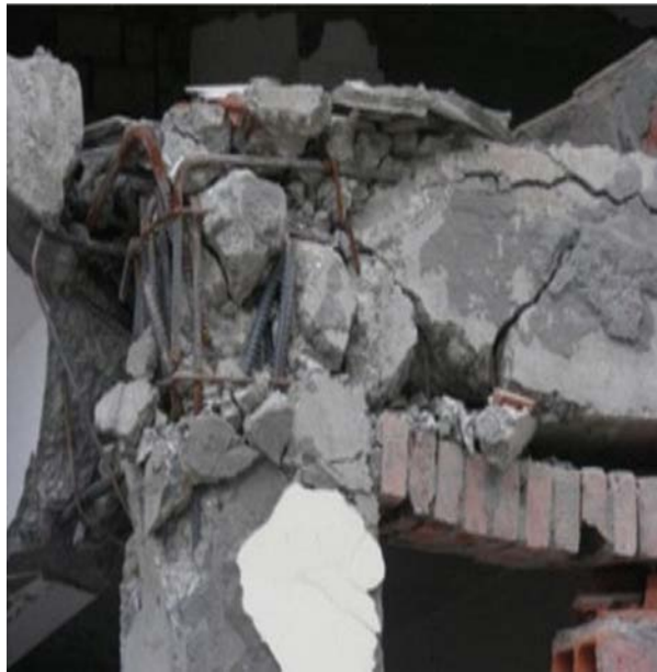
شکل (۲۳): شکست اتصال تیر - ستون به خاطر نبود خاموت‌ها در قسمت چشمه اتصال.
