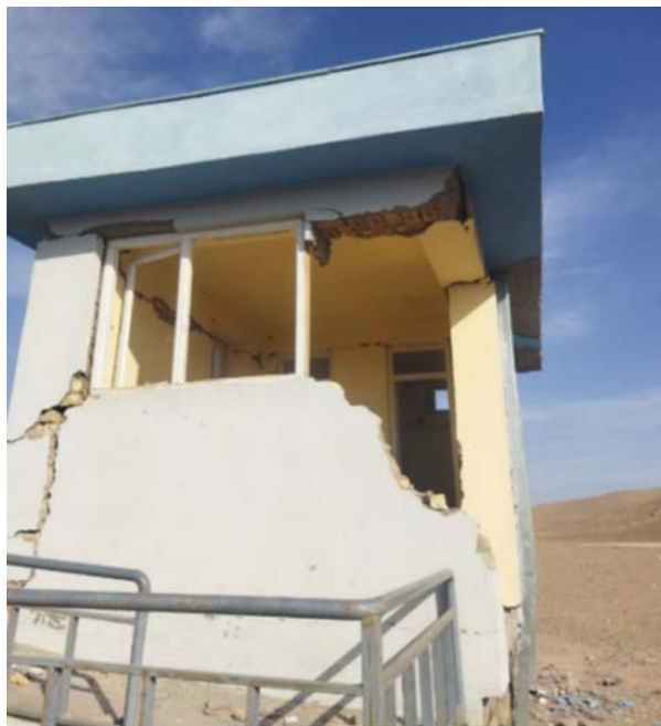
شکل (۲۹): تخریب دیوار از قسمت بازشو.
