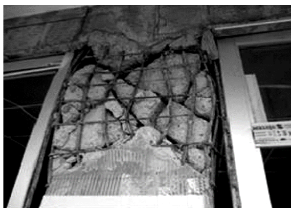
شکل (۱): آسیب دیدگی و شکست برشی ستون‌های کوتاه بتن مسلح [۳].
