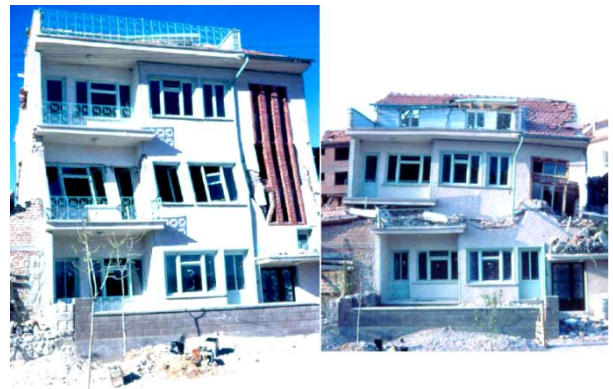
شکل (۱): ساختمان آسیب‌دیده بعد از لرزش اصلی زلزله گدیز در سال ۱۹۷۰ (عکس سمت چپ)، همان ساختمان پس از یک پس‌لرزه کوچک‌تر (عکس سمت راست) [۵].
