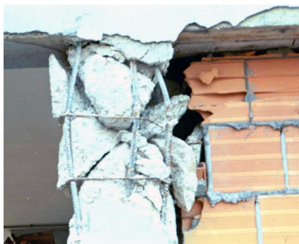
شکل (۱۱): شکست برشی ستون به علت تقابل با دیوار پرکننده آجری (ایتالیا-۲۰۰۲).
