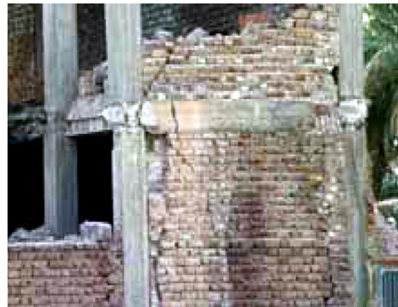
شکل (۱۲): شکست برشی تیر بتن مسلح به علت اندرکنش با دیوار پرکننده آجری (بم - ۱۳۸۲).
