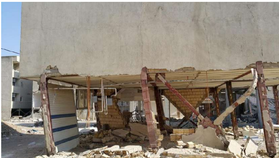
شکل (۲): کماتش اعضای مهاربندی ضربدری در زلزله ۱۳۹۶ سرپل ذهاب (عکس از پژوهشگاه بین‌المللی زلزله‌شناسی و مهندسی زلزله).
