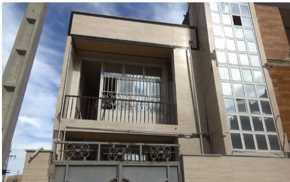
شکل (۵): ساختمان شماره یک؛ ساختمان بنایی دو طبقه با کلاف افقی در تراز سقف‌ها [۱۴].
