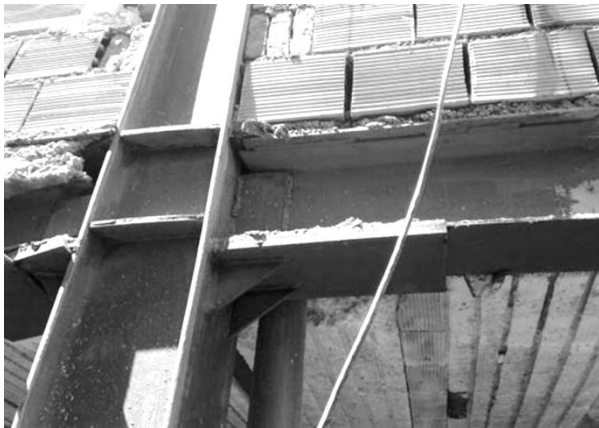
شکل (۱): نمونه اتصالات قاب مورد نظر برای شبیه‌سازی - عدم قرارگیری ورق‌های پیوستگی در محل درست.
