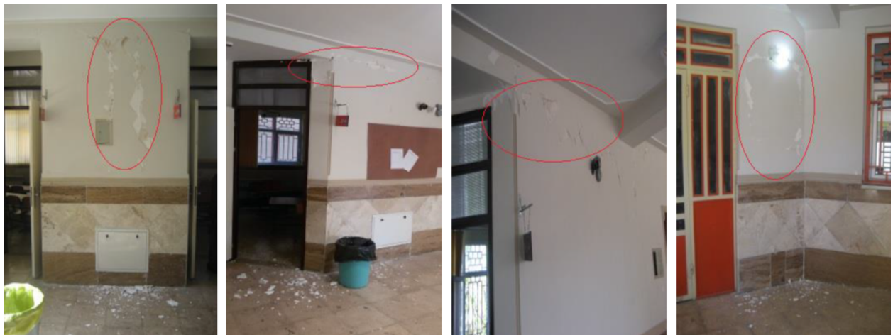
شکل (۱۱): ترک‌های سطحی در دیوارهای مدارس پس از زلزله ۲۱ آبان ۱۳۹۶ استان کرمانشاه (Kahrizi et al., 2020).
