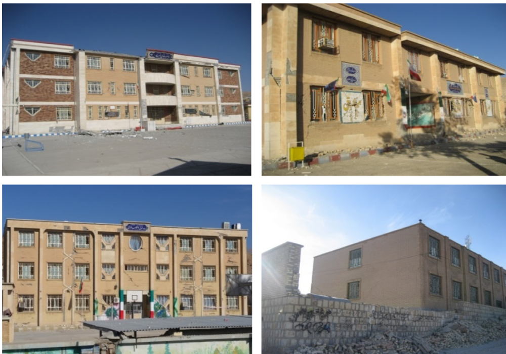
شکل (۱): نمونه‌هایی از آسیب‌های وارد به مدارس به زلزله آبان ماه ۱۳۹۶ از گله کرمانشاه.
