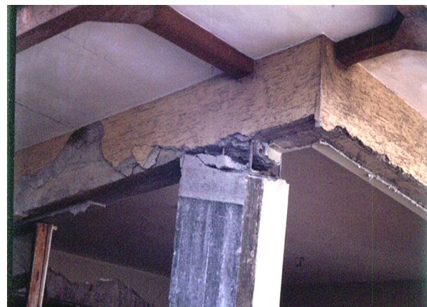
شکل (۲): جدا شدن ستون از تیر در تکیه‌گاه.
