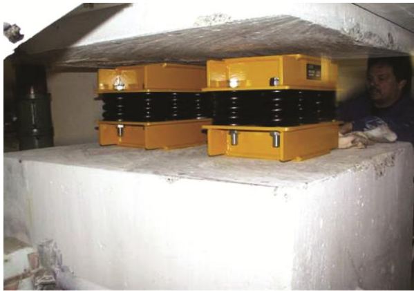
شکل (۱۲): تکیه‌گاه فنی برای ایجاد جداسازی در راستای قائم و افقی (جداسازی سه‌بعدی).
