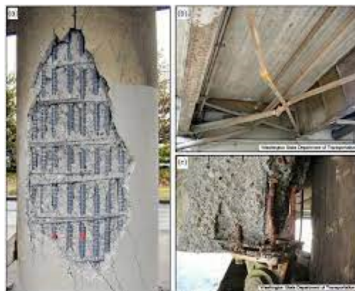
(پ) آسیب از نوع قلوه کن شدگی شدید
