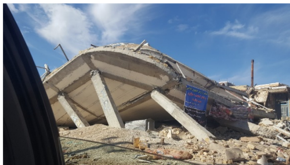
شکل (۲۵): فروریزی ساختمان بتنی در زلزله کرمانشاه به علت عدم اجرای درست تنگ‌ها.
